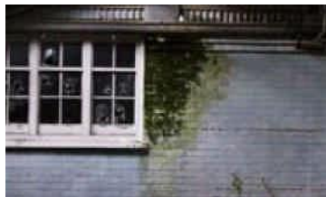
Wilgoć penetrująca jest bardziej zauważalna podczas deszczu
