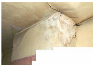
Wewnętrzna wilgoć penetrująca rury, jeśli podejrzewa się taki problem należy jak najszybciej to sprawdzić i naprawić.
